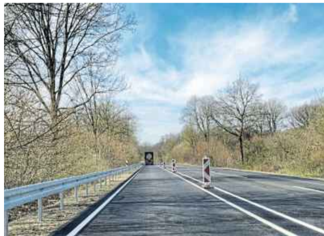
Nur noch bis kommenden Dienstag ist die Ostwestfalenstraße in Fahrtrichtung Lemgo gesperrt. Die Markierungen für die 2+1-Überholspuren sind bereits aufgetragen. Foto: Thomas Reineke
